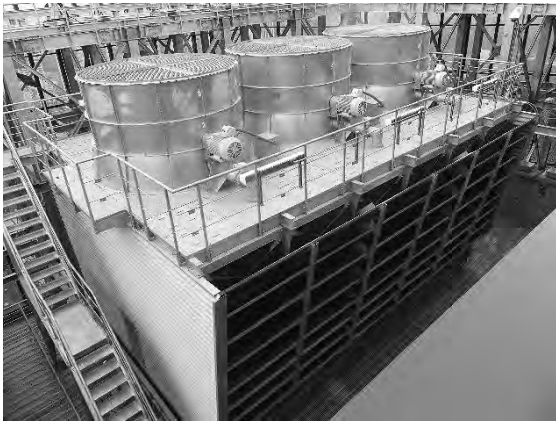
屋上のDHC用冷却塔
