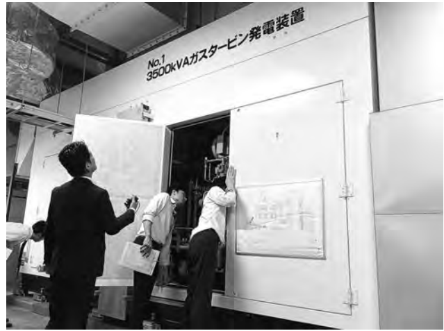
地下3階の防災用ガスタービン発電設備
