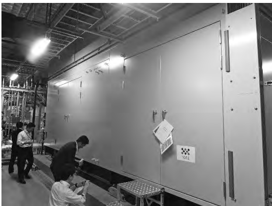
地下3階のCGSの設備（常用ガスエンジン式発電設備）
