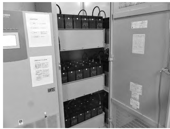
UPS盤に収められた鉛蓄電池
