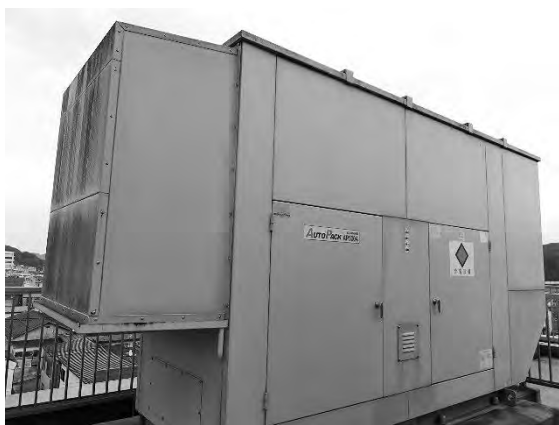
後藤医院の自家発 （ディーゼル機関駆動250kVA×1基）
