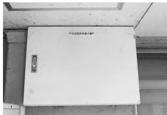
仮設電源用端子盤
