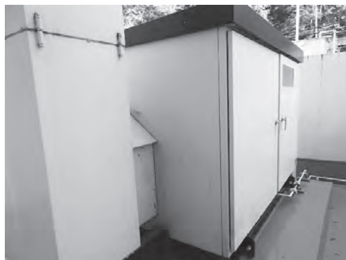
新里庁舎の自家発 （ガスタービン駆動187.5kVA×1基）
