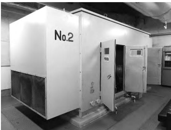
宮古病院の自家発 (ディーゼル機関駆動500kVA×2基)
