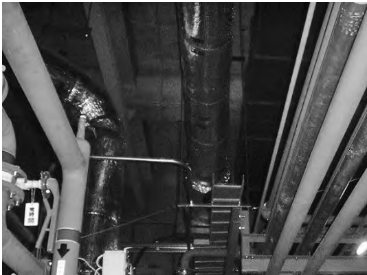
配管のT字エルボの空気溜り
