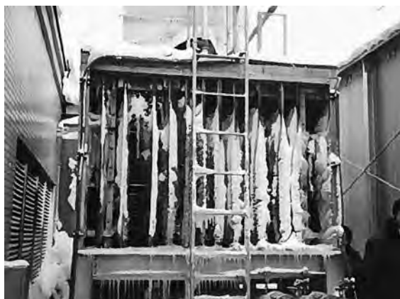
散布水が氷結した冷却塔
