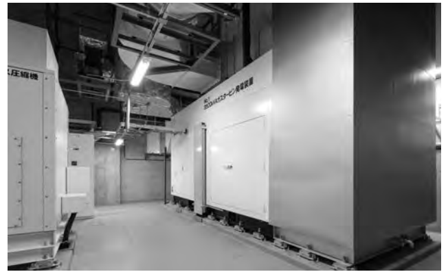
赤坂インターシティAIRのビル用非常用発電機 (ガスタービン3,500kVA×2台)
