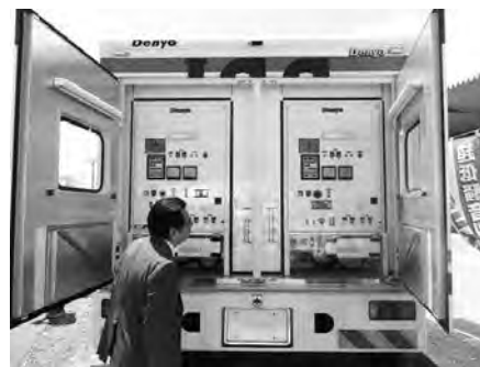
移動電源車（150kVA×2台）
