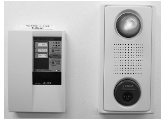
操作実演用の火災報知機の実機
