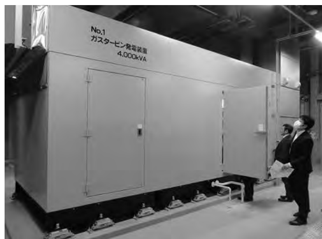
写真5 非常用自家発電設備の外観
