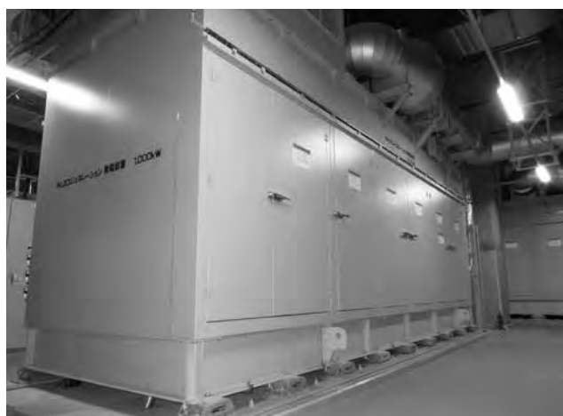
写真3 常用自家発電設備（CGS）の外観
