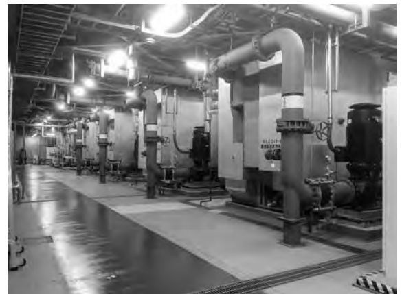
熱源機械室の蒸気吸収式冷凍機(800冷凍t×4基)
