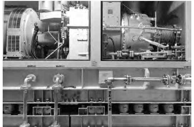
非常用デュアルフューエル・ガスタービン
