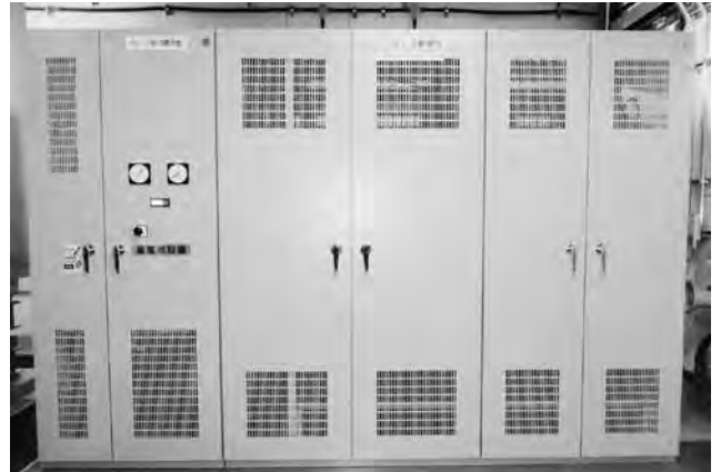
発電機室の直流電源・蓄電池
