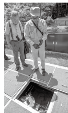
人工芝を模した天板の下に敷設された配水管網
