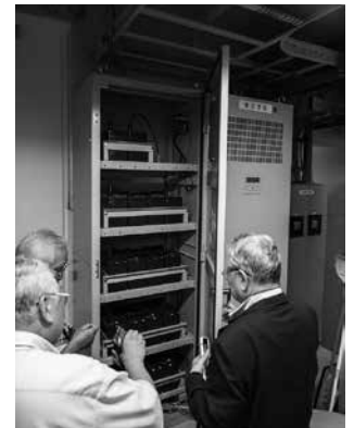
西庁舎の発電機室の盤
