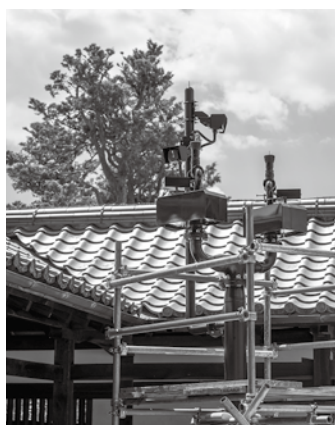
放水銃等の消火設備
