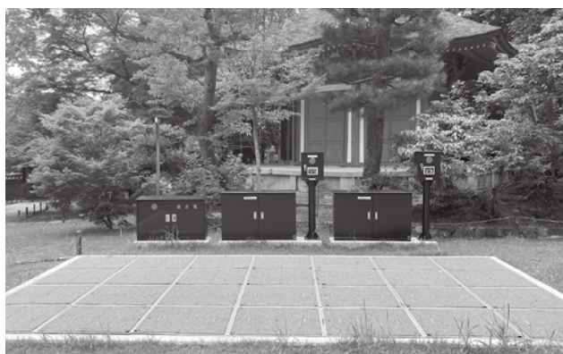
ポンプ場から給水を受ける簡易操作性消火栓
