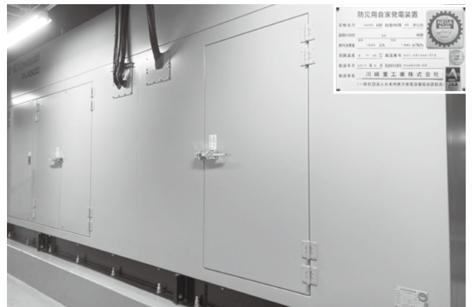
防災用カワサキガスタービン発電装置と製品認証票
