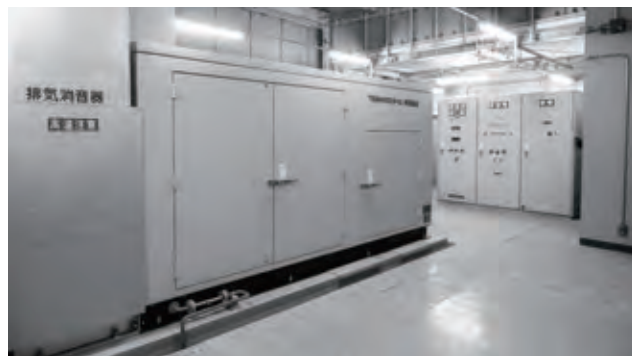
金沢駅の配電所の750kVA非常用ガスタービン発電装置
