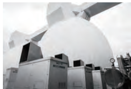
ヤンマー製25kW消化ガスコージェネレーションシステムと消化タンク
